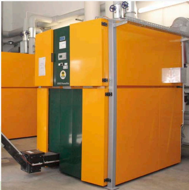
Anlagen für die Wärmeerzeugung mit Pellets und Hackschnitzeln
