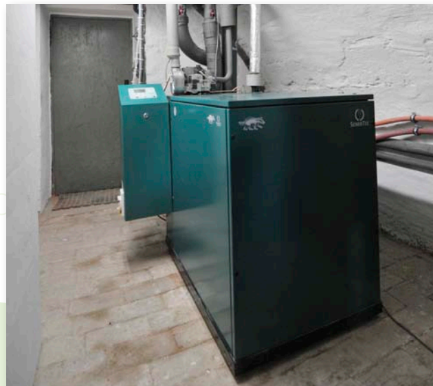
BHKW im historischen Keller
