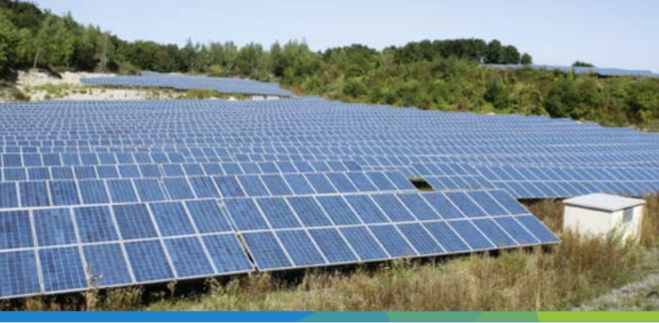
Freiflächensolaranlage im ehemaligen Kalkbergwerk Gersheim
