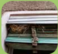
Spatzennistplatz im Jalousiekasten, Foto: BUND Hannover
