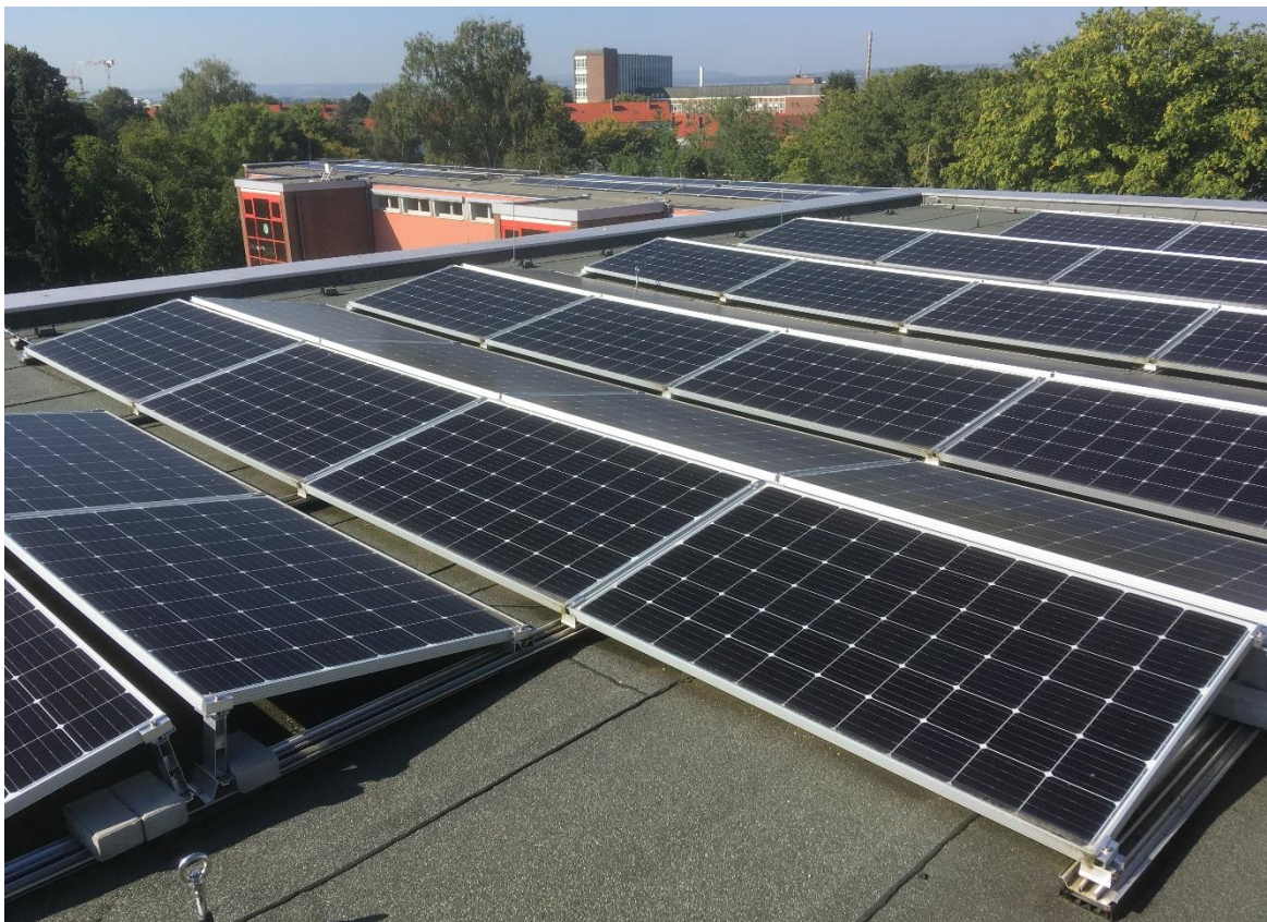
Abbildung 5: PV-Anlage (Quelle: Stadt Göttingen Fachbereich Gebäude)
