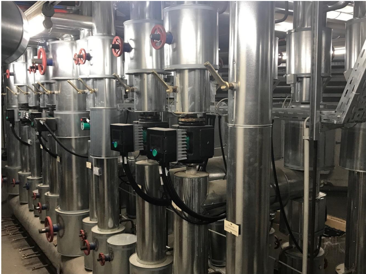
Abbildung 3: Heizungsverteiler (Quelle: Stadt Göttingen Fachbereich Gebäude)
