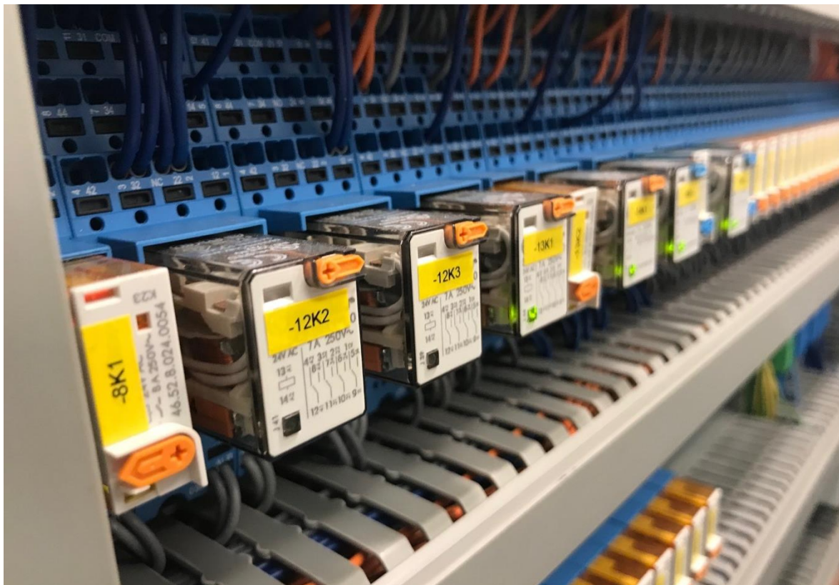
Abbildung 6: Schaltschrank (Quelle: Stadt Göttingen Fachbereich Gebäude)
