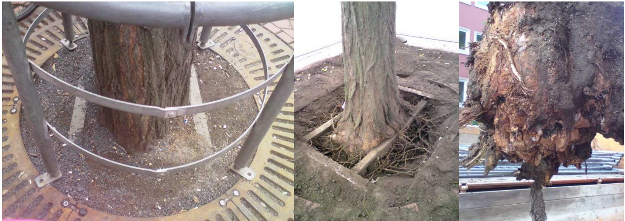
Abb. 19: Stahlkonstruktion in der Pflanzgrube und stockfaule Straßenakazie
