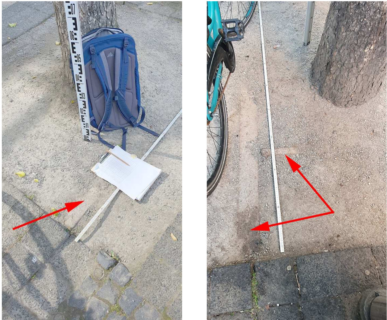
Abb. 4: links: Blick auf die Baumscheibe der Baumhasel Nr. 1753 und rechts auf die Baumscheibe der Baumhasel Nr. 1757 mit stammfußnah eingebauten Stahlträgern
