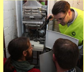
Abbildung 2: Heizungsoptimierung spart auch Holzbrennstoff. Quelle: Energieagentur Region Göttingen e.V.
